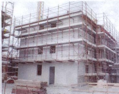
Un edificio in costruzione (foto d'archivio); in 30 anni la cooperativa ha costruito molto
